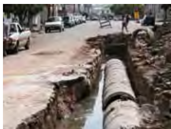
Problemas na tubulação de esgoto da RMB – GPHS/UFGA
