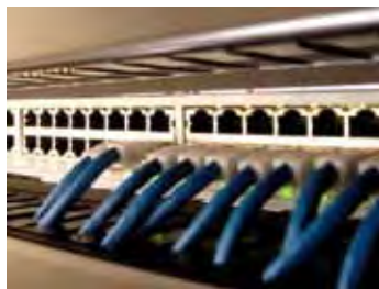
Cabos de Redes de Processamento – WebCollection
