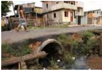
Esgoto a céu aberto em Belém – WebCollection
